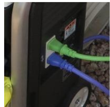
可搬型発電機からの給電
