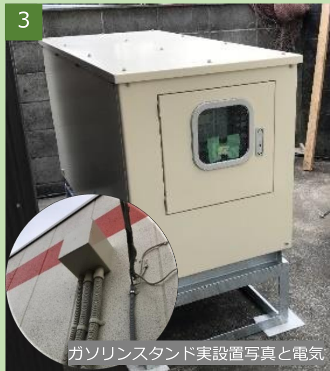
事務所横に設置した発電機と停電中/発電中を知らせるパトライト
