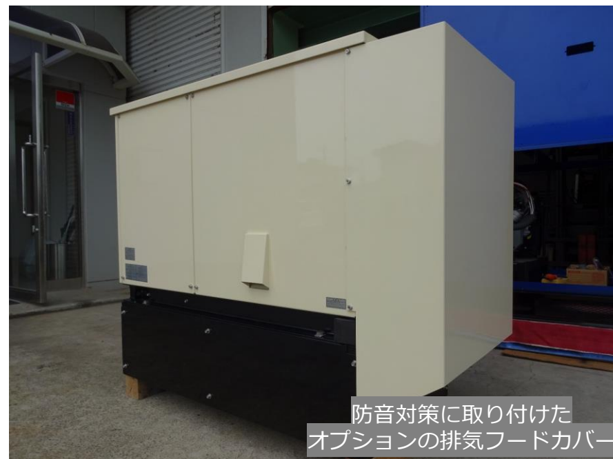
部室棟階段の下に設置した発電機
