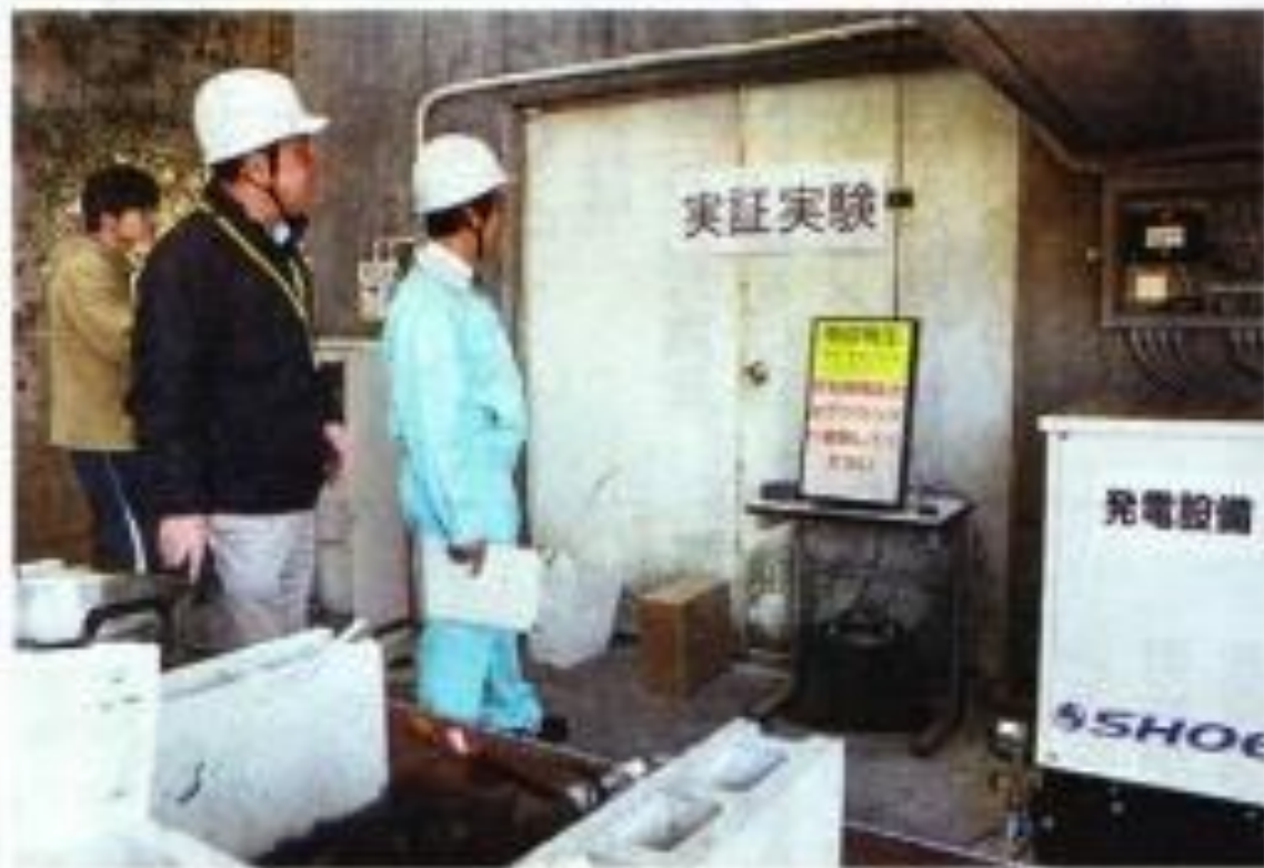
LPガスによる発電でWi-Fiの接続状況を確認した防災訓練＝静岡市駿河区の県立大草薙キャンパス
